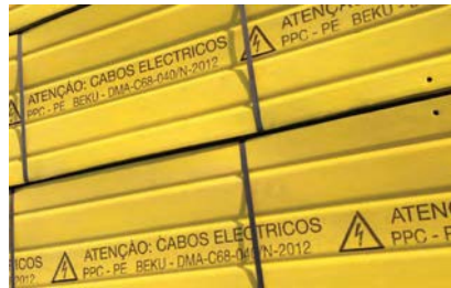
Placas para protecção de cabos enterrados.
